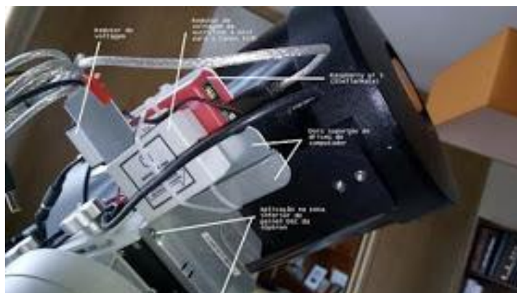
Sistema mecânico de suporte ao Rasberry Pi3 e redutores de voltagem
